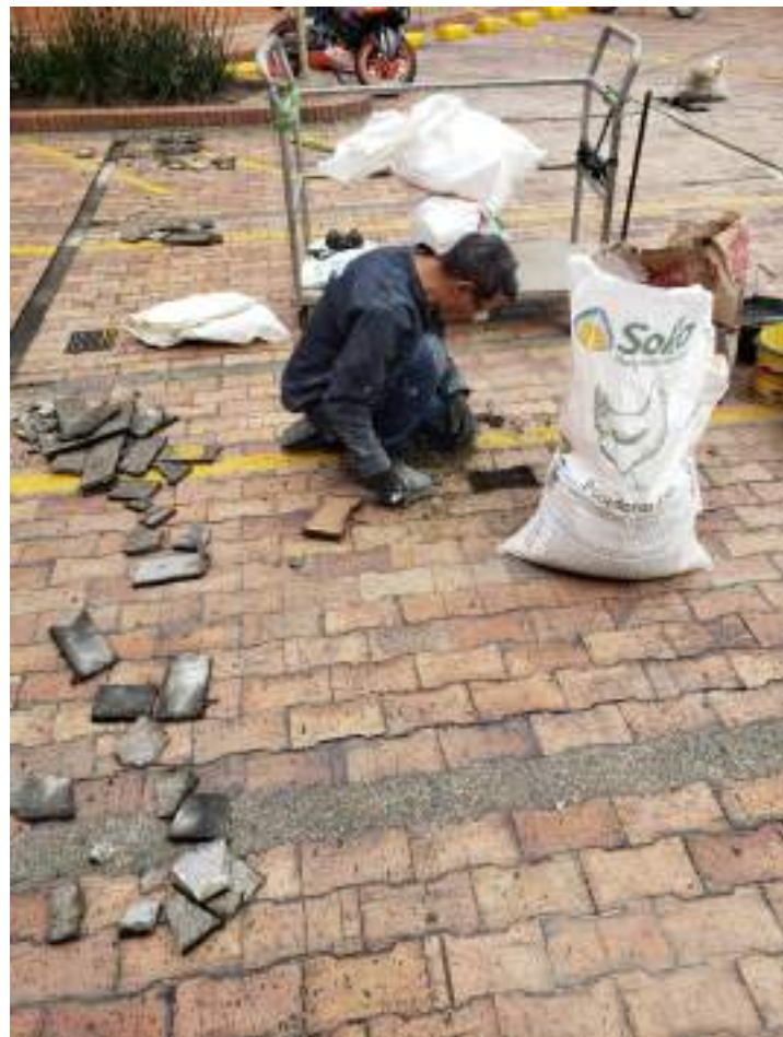
Arreglo de adoquines sueltos y granito fracturado en el p...
