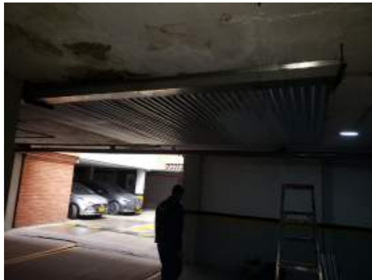
Techado de garajes afectados por filtración
