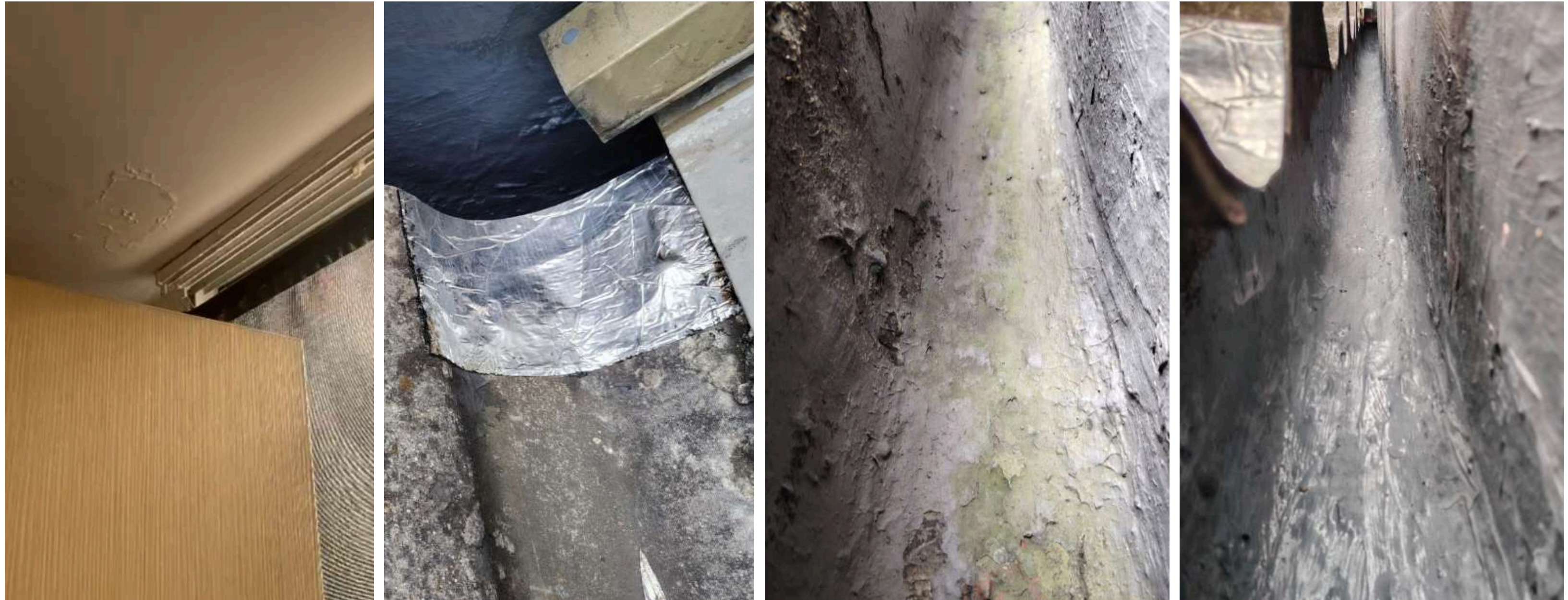
IMPERMEABILIZACIÓN TEJA Y VIGACANAL 9-504
