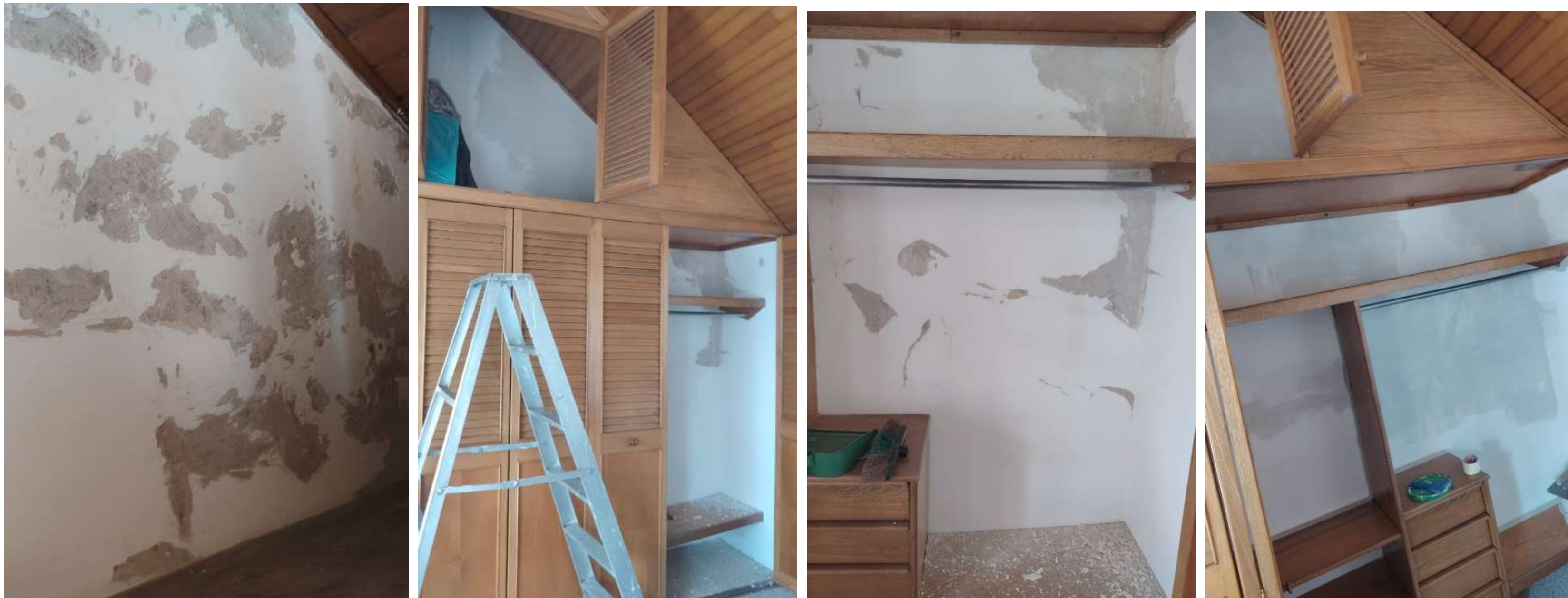
RESANE Y PINTURA POR HUMEDAD 8-504
