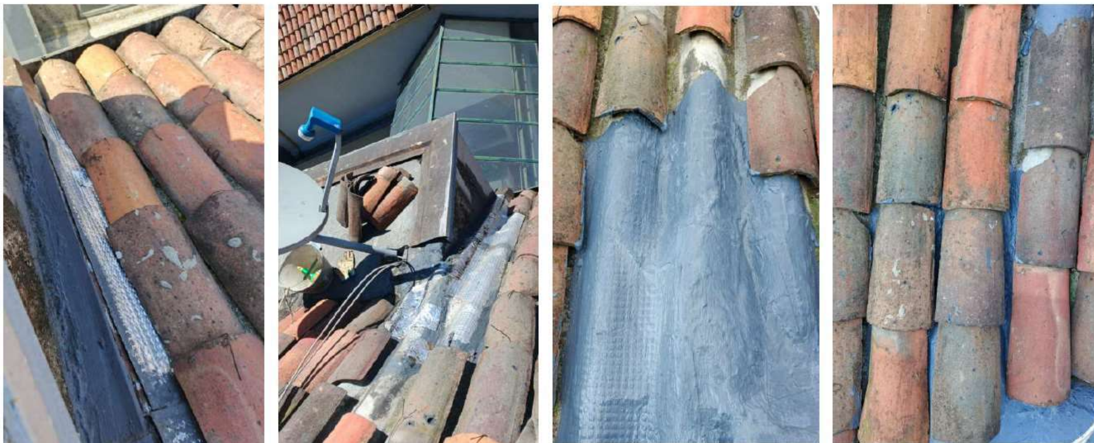
4-504 impermeabilización filtración en techo alcoba principal
